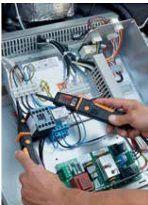
Spannungsmessung an einem Verdichter.
