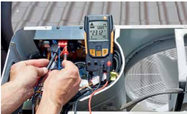
Spannungsmessung an einer Kälte-Außeneinheit mit testo 760 .
