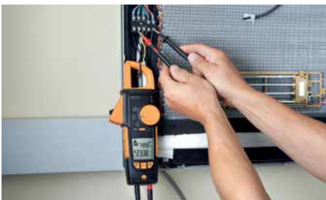
Spannungsmessung an einem Klimagerät mit testo 770 .
