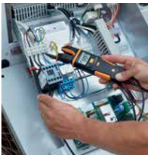
Spannungsmessung an einem Verdichter.
