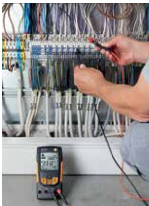
Spannungsprüfung am Schaltschrank.
