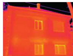
Wärmebild ohne testo ScaleAssist
