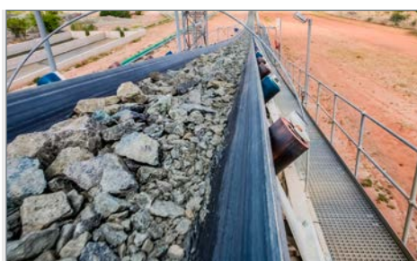
Überwachung von Förderbändern - Einsatz einer Xi 80 als effizientes Instrument für den Brandschutz.
