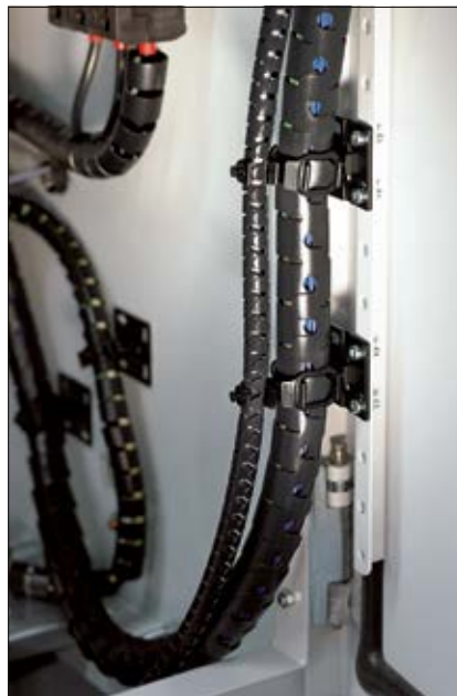
Proteger y fijar cables con Helawrap, sus cables estarán ordenados, protegidos y fijados en armarios y/o máquinas industriales.
