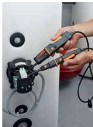
Spannungsmessung an einem Heizlastspeicher.
