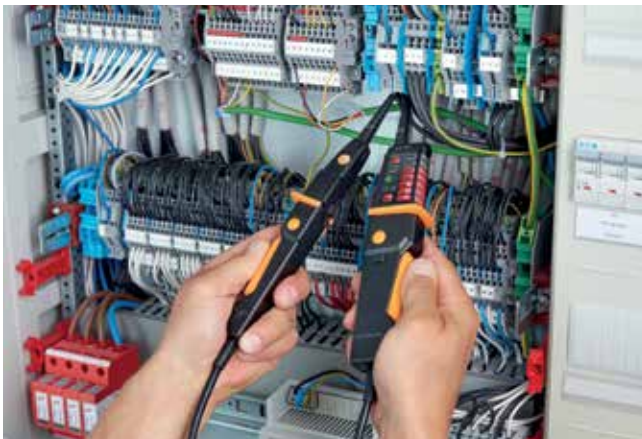
Spannungsmessung im Schaltschrank.
