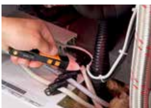
Erstprüfung der Spannungsversorgung an einem Verdichter.
