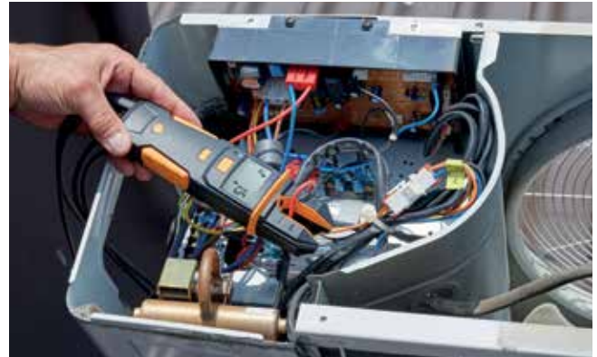
Strommessung an einer Kälte-Außeneinheit mit testo 755 .
