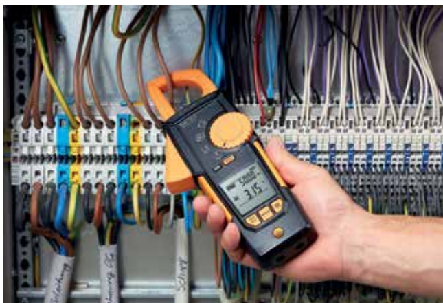
Strommessung am Schaltschrank.
