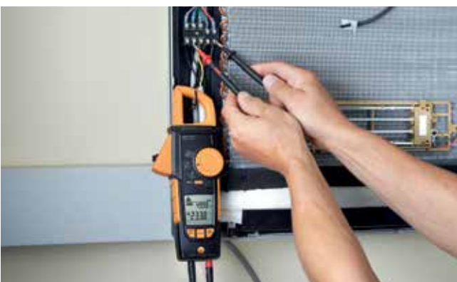
Spannungsmessung an einem Klimagerät mit testo 770 .
