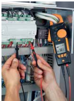
Spannungsmessung am Schaltfeld einer Wärmepumpe mit aufgehängtem Messgerät.
