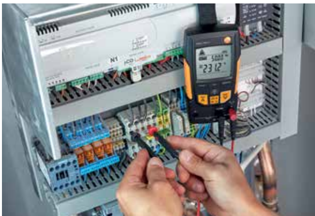
Spannungsprüfung am Schaltfeld einer Wärmepumpe.
