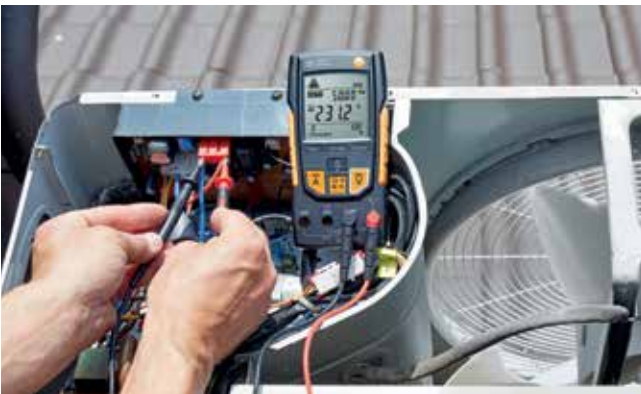
Spannungsmessung an einer Kälte-Außeneinheit mit testo 760 .
