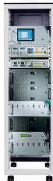
Applikation: Steuerung in Stellwerken
