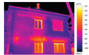
Wärmebild mit testo ScaleAssist
