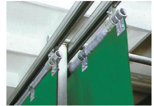
Schiebetüren beschleunigen den Werkverkehr und ermöglichen freie Durchfahrt.
