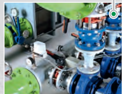
... Pumpen in Industrieanlagen
